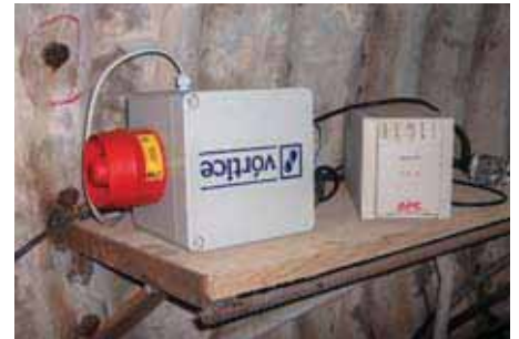
Figura nº 12 Sistema de controlo de cheias, com sirenes, de aviso nas frentes de trabalho.
