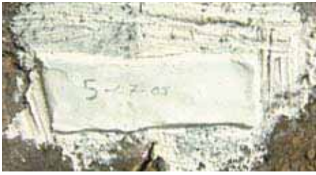
Figura nº 14 Testemunhos em gesso (2 a 3 mm de espessura), para detectar movimentos em fendas e fissuras. Deve-se colocar a data de instalação. Este sistema permite a visualização directa.
