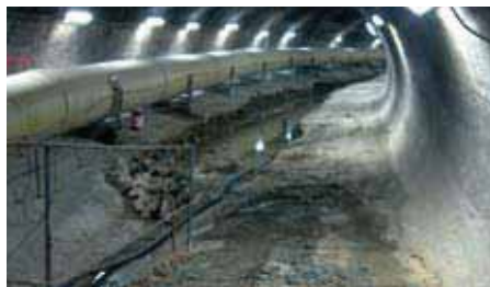
Figura nº 10 Sistema de iluminação. Em caso de falta de energia, a iluminação mantém-se cerca de uma hora em funcionamento, permitindo a evacuação em condições de segurança.
